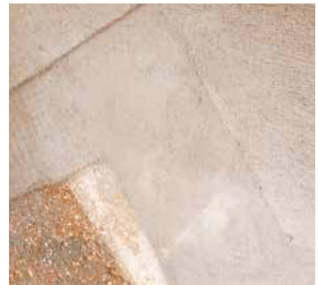
Die Mörtelschutzschicht wird lagenweise auf dem vorbereiteten und ausreichend vorgemasteten Untergrund hergestellt.
