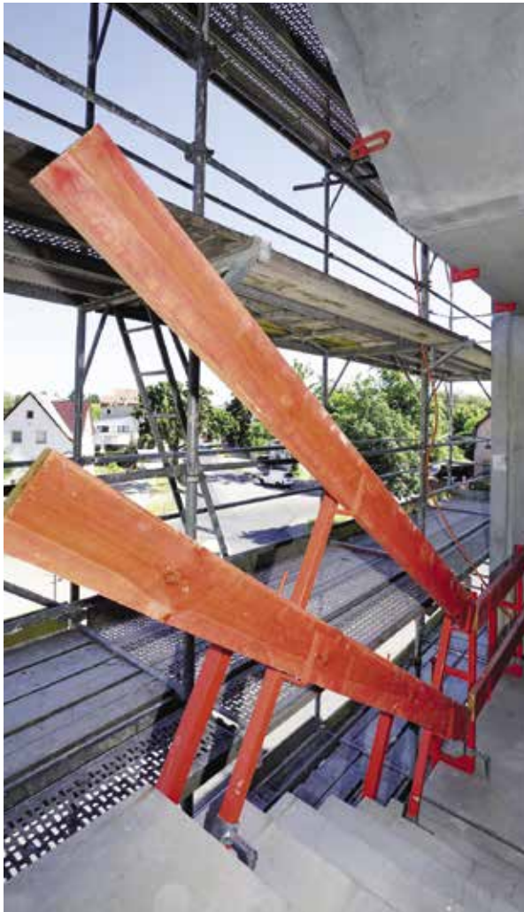
Absturzsicherungen im Treppenbereich
