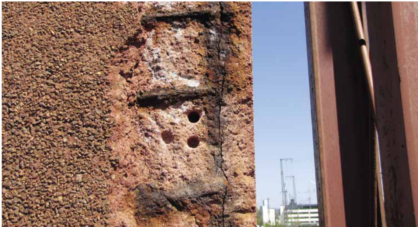
Fortgeschrittene Bewehrungskorrosion im Stützpfiler einer Fußgängerbrücke
